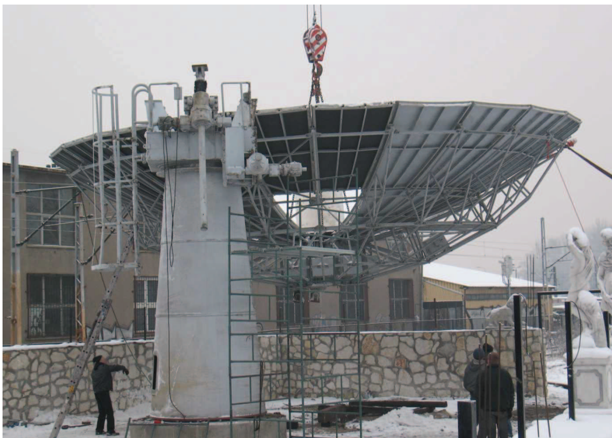
Fot. 19. Najbardziej niebezpieczny moment podnoszenia czaszy. Odległości kolizyjne w każdą stronę poniżej jednego metra, dopuszczalne parametry pracy dźwigu przekroczone.
